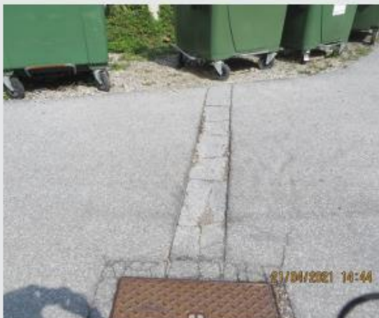
Nesaniiran prekop občinske ceste na Ulici Otona Župančiča
