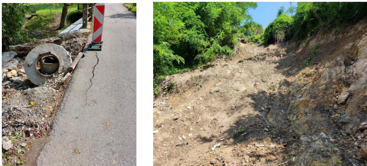
Slika 31: Okvari na kanalizaciji Pot v Trnje in Grilčeva ulica
