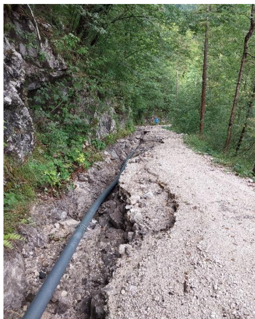
Slika 26: Poškodovano vodovodno omrežje Slanice
